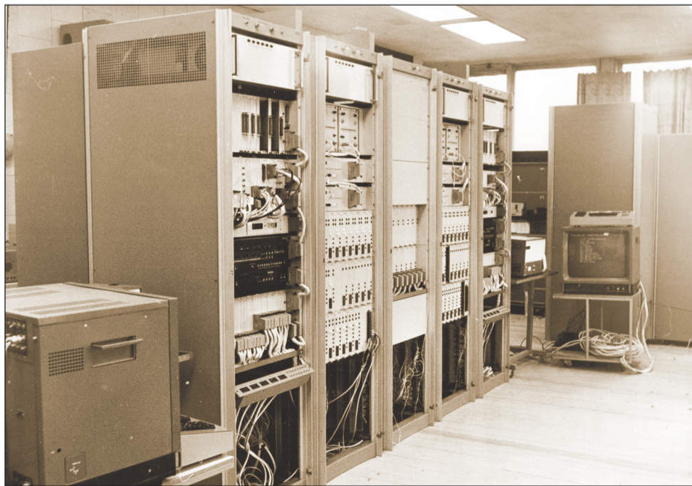
Система внутриреакторного контроля (СВРК) «Гиндукуш» на прогоне, 1979 год
